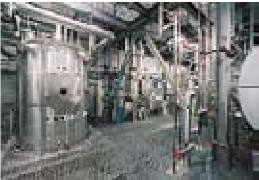
Tweede etage van een Biodieselfabriek. Links een opslagtank, in het midden een droger voor biodiesel.
